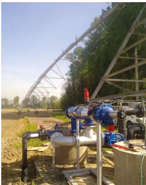
Sistema di filtrazione.
