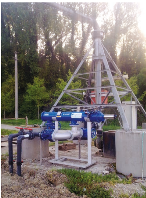
Torre del sistema Pivot.
